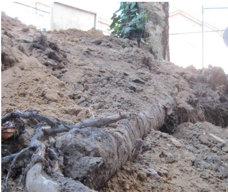
Offene, beschädigte Baumwurzel aufgrund unzureichender Baustelleneinrichtung und Baumschutzmaßnahmen sowie einer nicht ausreichend fachkundigen Bauleitung
